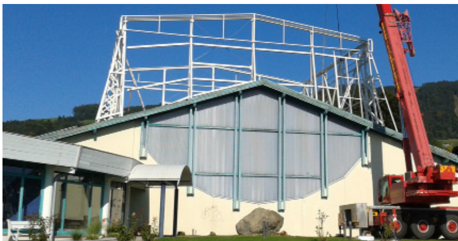
Das Gerüst für den Kletterturm im Vitaclub Mondsee wächst in die Höhe. Noch heuer ist Eröffnung der Kletterhalle. Foto: REGMO
